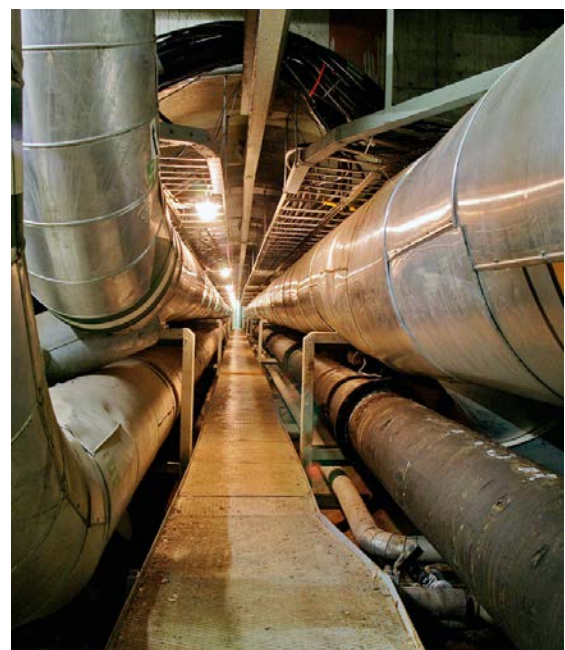
Der Hauptsammelkanal zweier Fernwärmetrassen. Foto + oben: EVH GmbH
